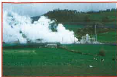
Photo 31: Vue de la centrale géothermique du Pico Vermelho à Ribeira Grande. Cette station pilote fonctionne depuis 1980 et produit actuellement 0.8 MW.
